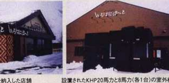
栗林石油がKHPを導入した店舗 設置されたKHP20馬力と8馬力(各1台)の室外機
